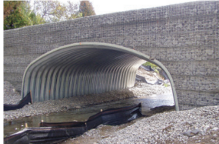
MUR DE SOUTÈNEMENT DE SOL STABILISÉ MÉCANIQUEMENT AVEC FAÇADE EN TREILLIS MÉTALLIQUE AVEC ROCHES
